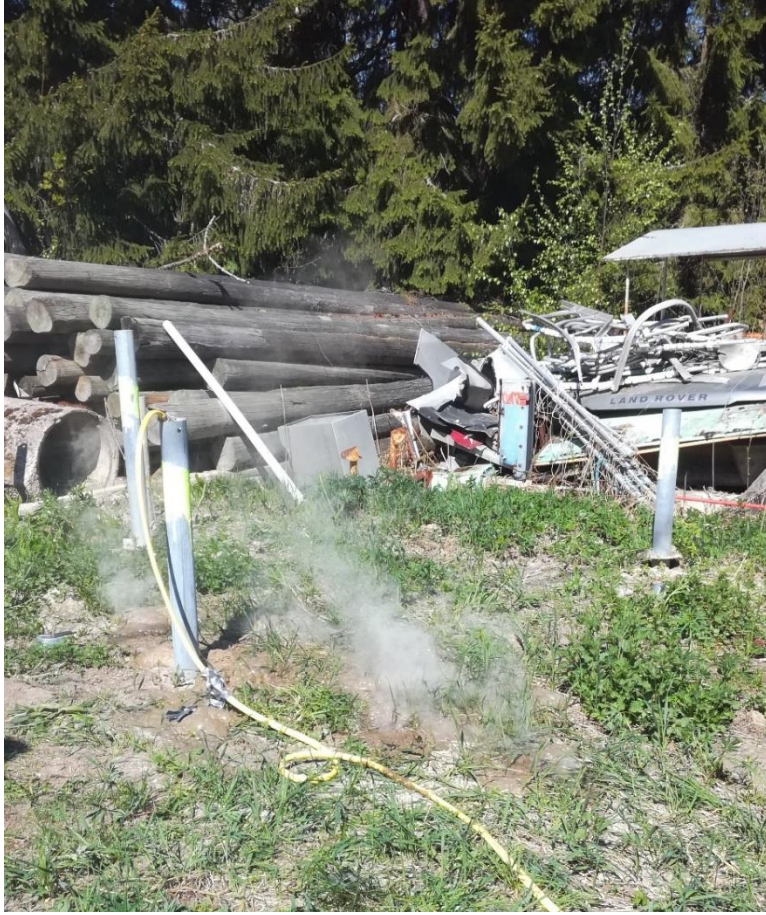
Liite 8. Keväällä vetyperoksidisyötön jälkeen pintamaassa havaittiin muodostuvan kaasua/vesihöyryä. Tällöin PID-mittarilla mitattu VOC-pitoisuus oli noin 20 ppm. Vaikutus oli hyvin väliaikainen.
